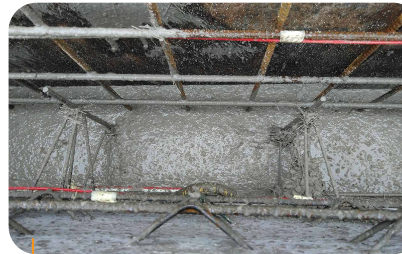
De monitoring met druksensoren gaf een perfect beeld van de reële ontwikkelde verse betondrukken tijdens het stortproces van het kernbeton.
