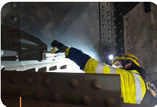
De installatie van de sensoren gebeurde gefaseerd in functie van de beschikbaarheid van de brug, ook 's nachts.
