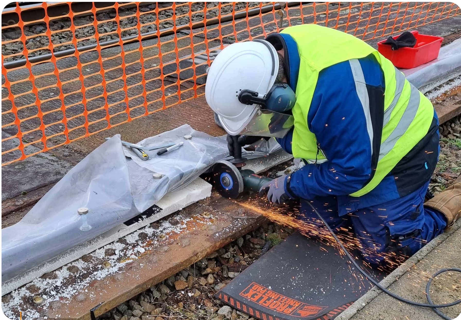
In Ronse werden met een slijpschijf artificieel scheurtjes in de bovenflens van een hoofdlijger aangebracht.
