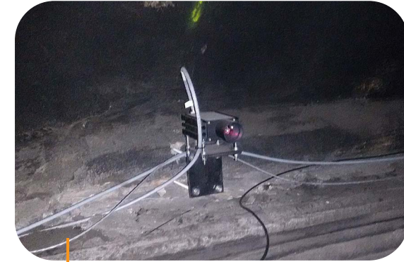
Laser-gebaseerde afstandsmeter gebruikt voor het opmeten van de ovalisatie van de tunneldoorsnede.
